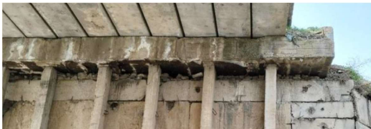
Рис. 3. Замачивание ригеля мостовой опоры из-за нарушения водоотвода
