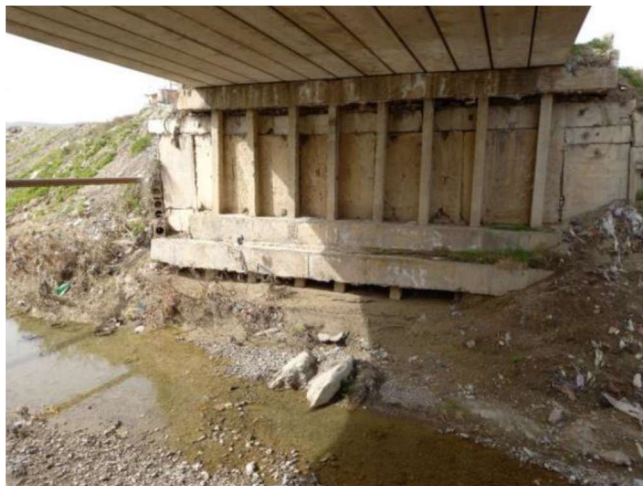
Рис.1. Размыв береговой опоры моста через реку Сангзар
