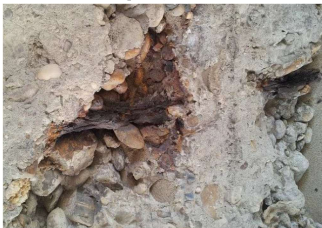
Рис. 2. Отслоение защитного слоя бетона и коррозия арматуры, вызванные совместным действием хлоридов и карбонизации
